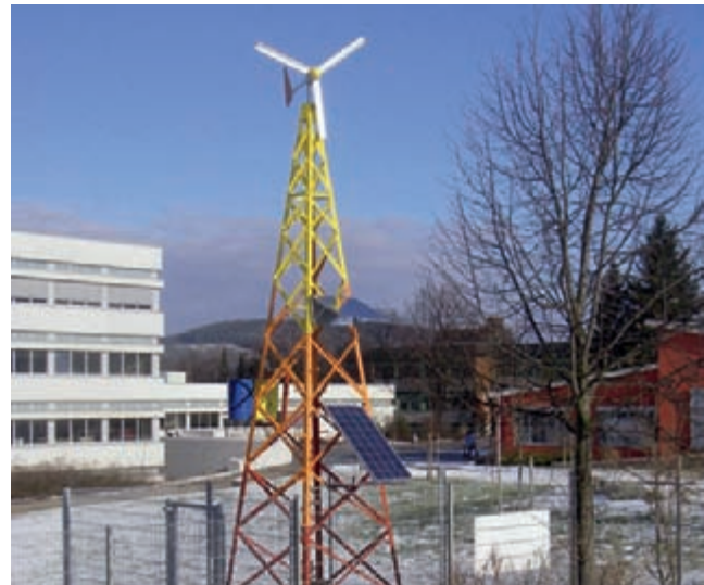
Energieturm mit Windgenerator und Solarpanel
